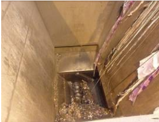
Obr. č. 3: Odpad se dále drtí a upravuje do podoby standardizovaného paliva, což je upravený, homogenizovaný a kvalitativně definovaný materiál.
